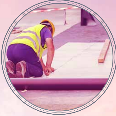
تسرب المياه Waterproofing
